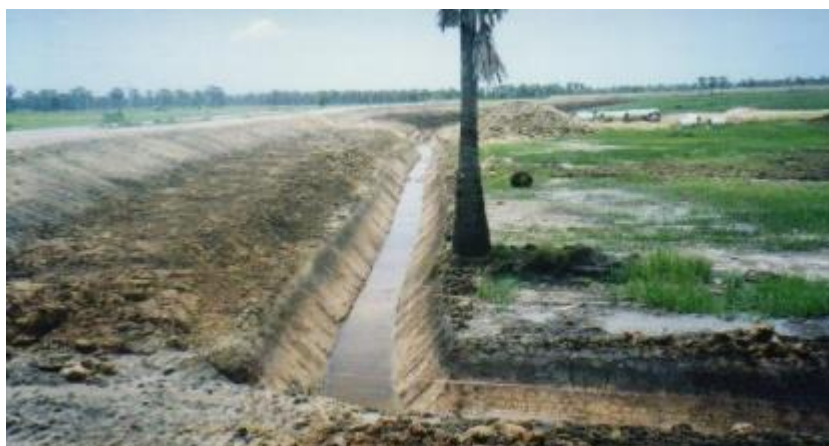
รูปที่ 6.16 รูปแสดงการระบายน้ำลงรางระบายน้ำข้างถนน
